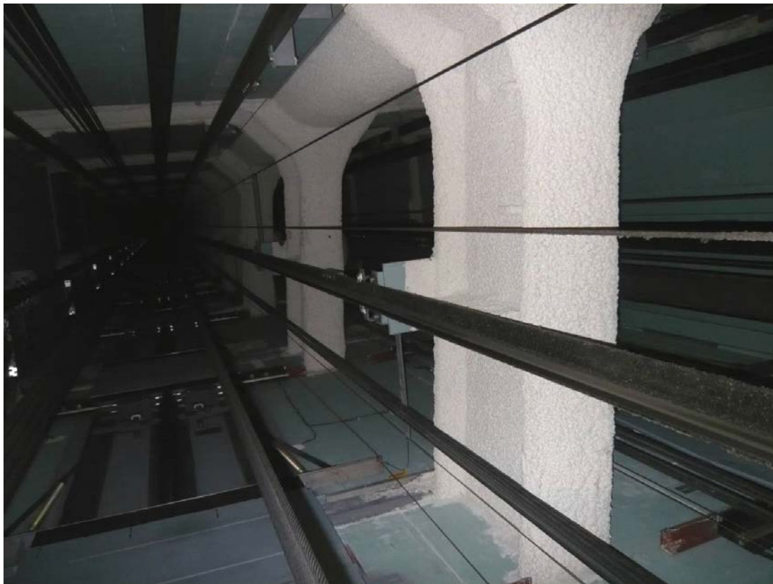
エレベーター昇降路内
